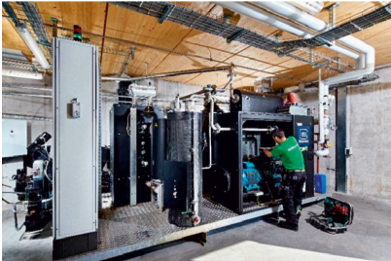
Heim AG - Heizsysteme
